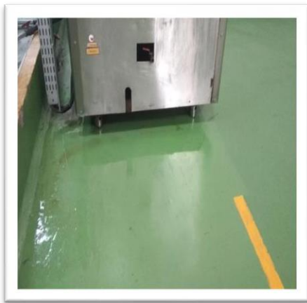
Kondisi lantai licin
